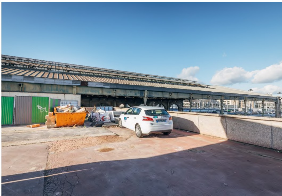
Figure 35 : État initial de la façade ouest, coté extérieur (nouveau hall des départs)
